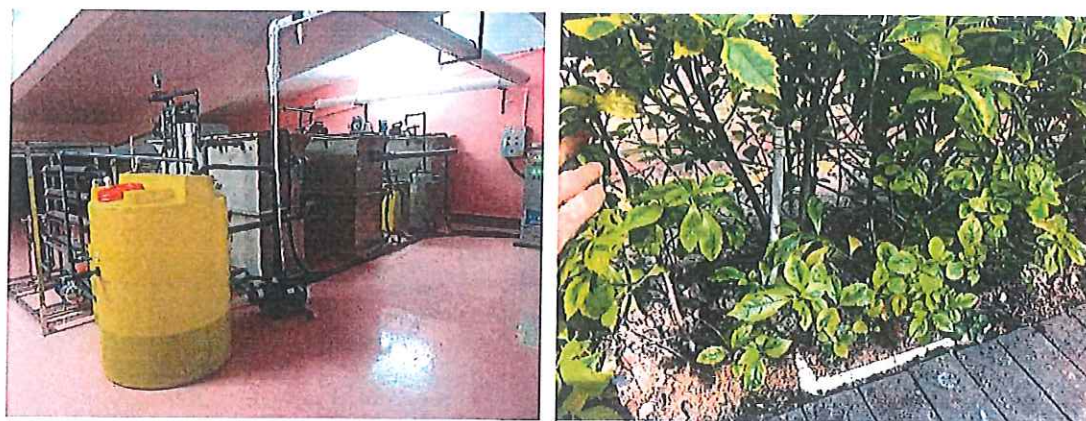
地下室污水处理设备
